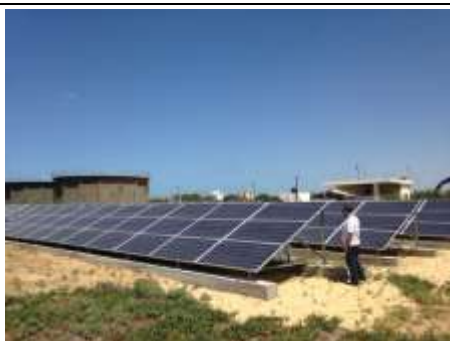
【写真5】下水処理場脇に設置された太陽光パネル（2017年9月）
