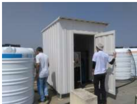
【写真2】学校の屋上に設置された小型脱塩処理施設の視察を行う当会スタッフ（右）（2017年7月）
