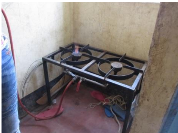
【13】 バイオガスのコンロ
